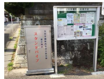
東急台支部に設置のスタンドパイプ
